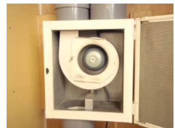
24時間換気システムの本体内部
