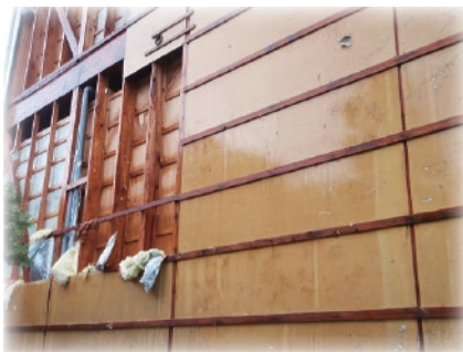
・台風により外壁がめくれてしまった現場
